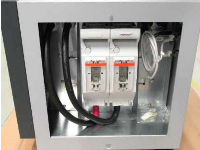
Abbildung 4-7 Batteriespeichersystem, Seitenansicht geöffnetes Gehäuse
